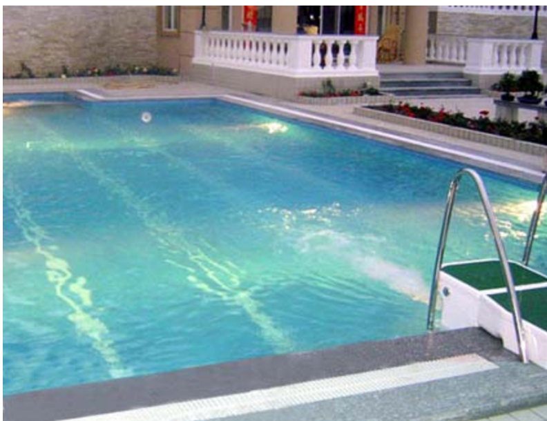
Artsy εγκατεστημένο σε ιδιωτική πισίνα — μονάδα στο χείλος (δεξιά) με ανοξείδωτες χειρολαβές
