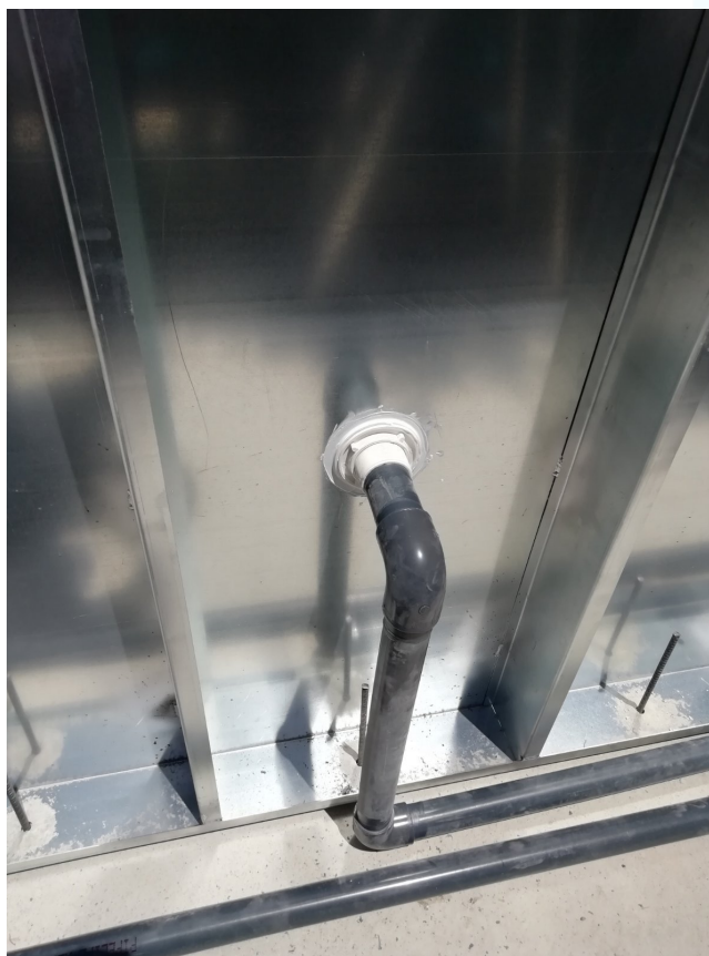
Σχήμα 8.6 Στόμιο εισροής (inlet) από την πίσω πλευρά: το ρακόρ σφίγγει το πάνελ και από κάτω η γωνία και ο σωλήνας οδηγούν το νερό από το μηχανοστάσιο.
