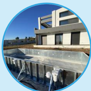
Paneles de acero con refuerzos y fijaciones
